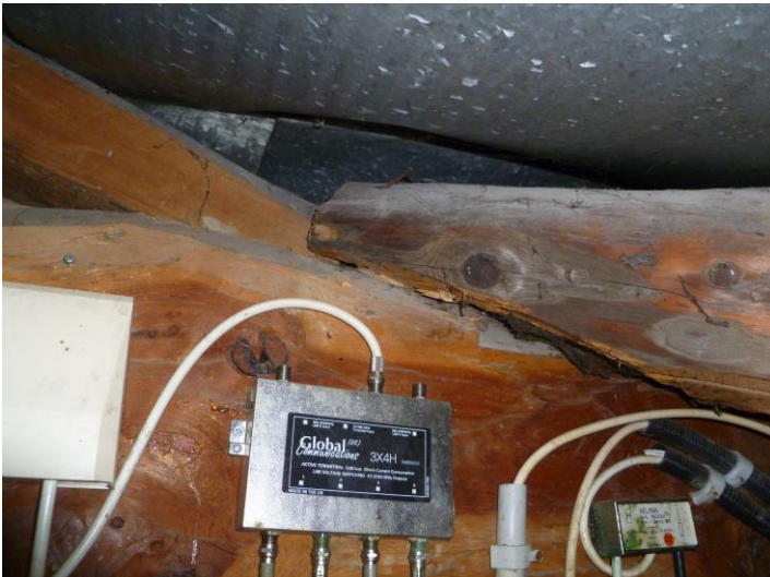
Impianti al di sopra del controsoffitto
