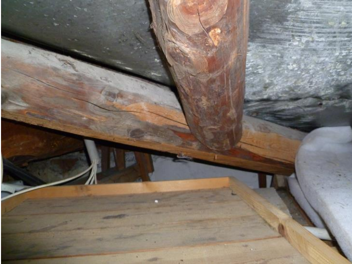
Impianti al di sopra del controsoffitto
